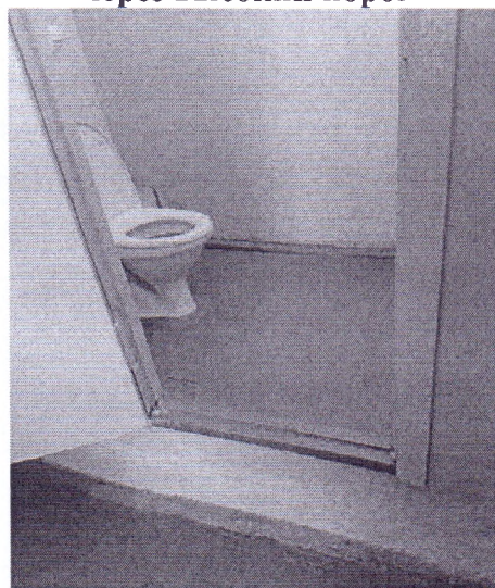
Фото № 2. Доступ к туалету через высокий порог
